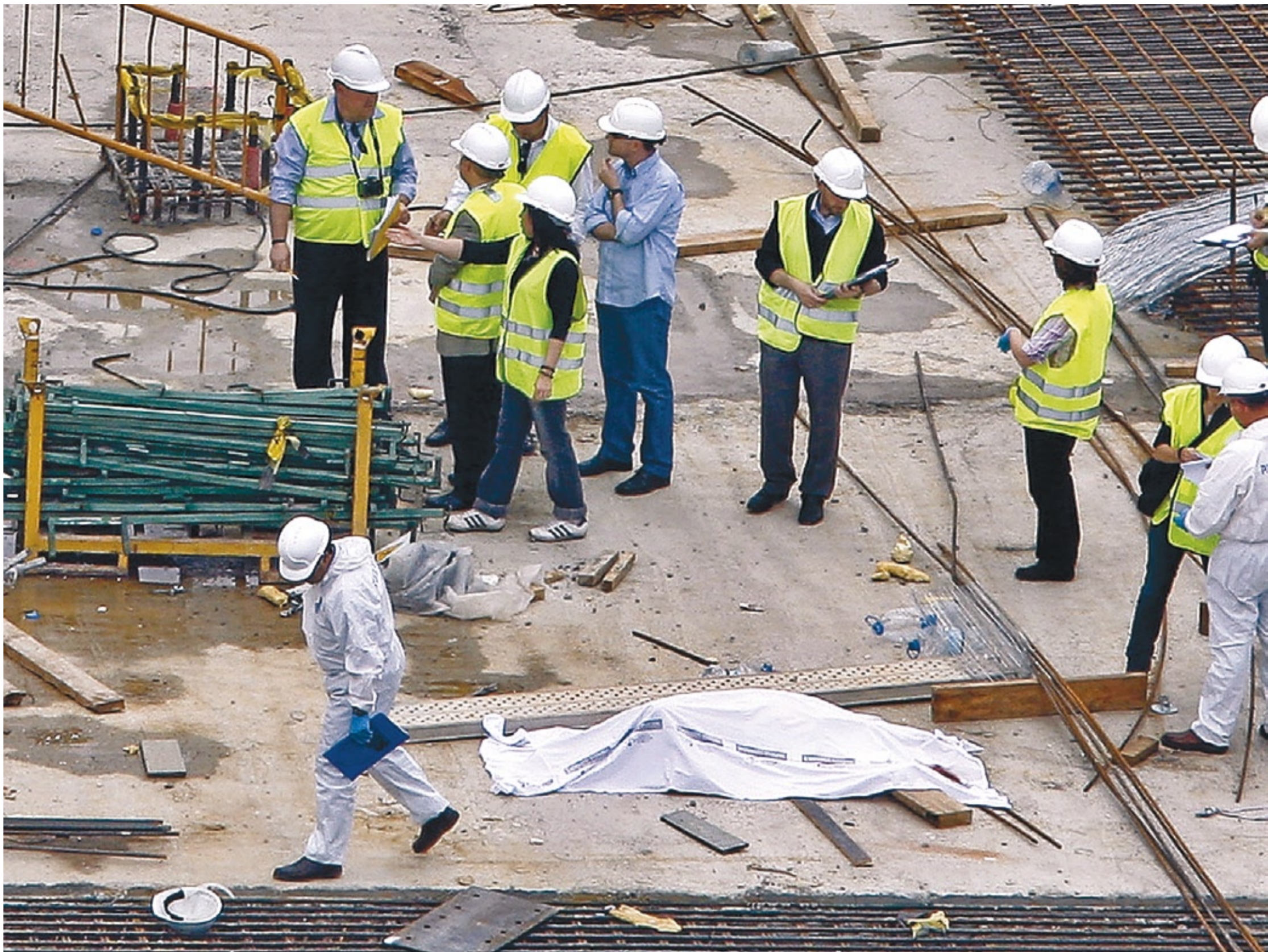
Imagen del accidente en el que murieron cuatro obreros en la construcción del Nuevo Mestalla, en el 2008, al caer el encofrado de un pilar a una altura de 12 metros.
